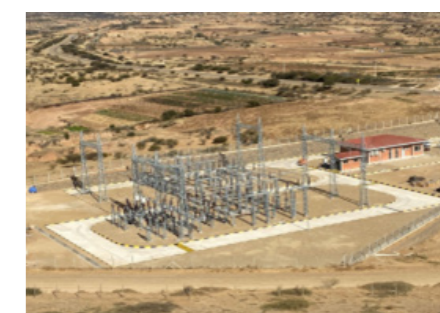
Subestación La Angostura, Tarija
