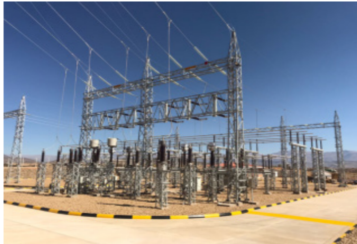
Subestación La Angostura, Tarija
